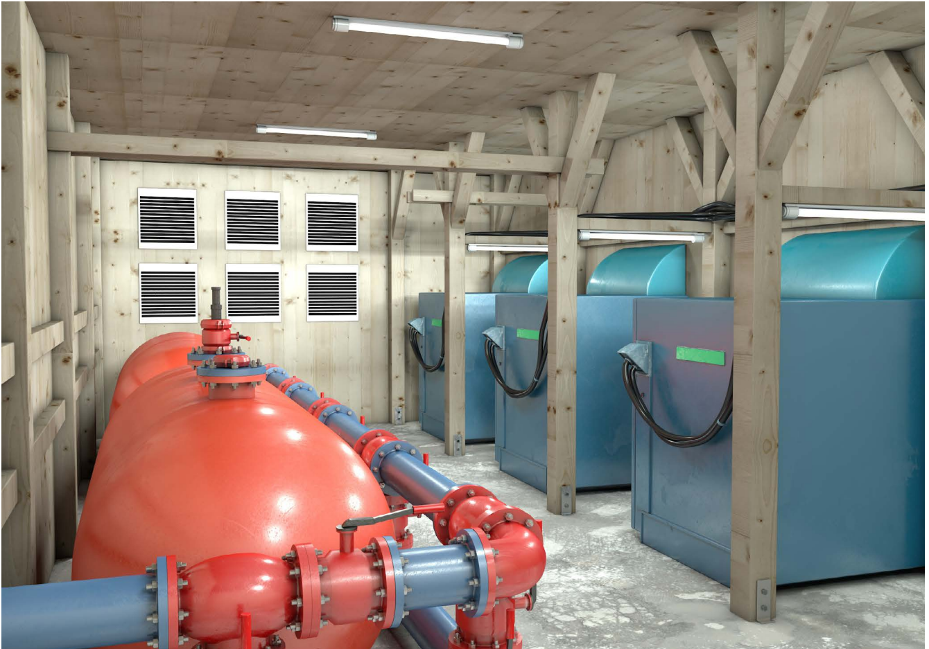
Abb. 1 Vor Sonneneinstrahlung geschützte Kompressoranlage und Druckbehälter
