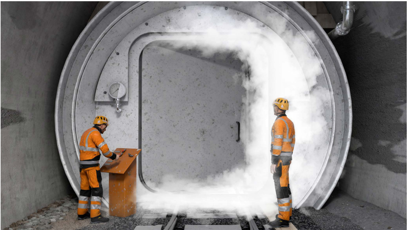
Abb. 5 Materialschleuse (atmosphärische Seite) nach dem Öffnen der Schleusentür
