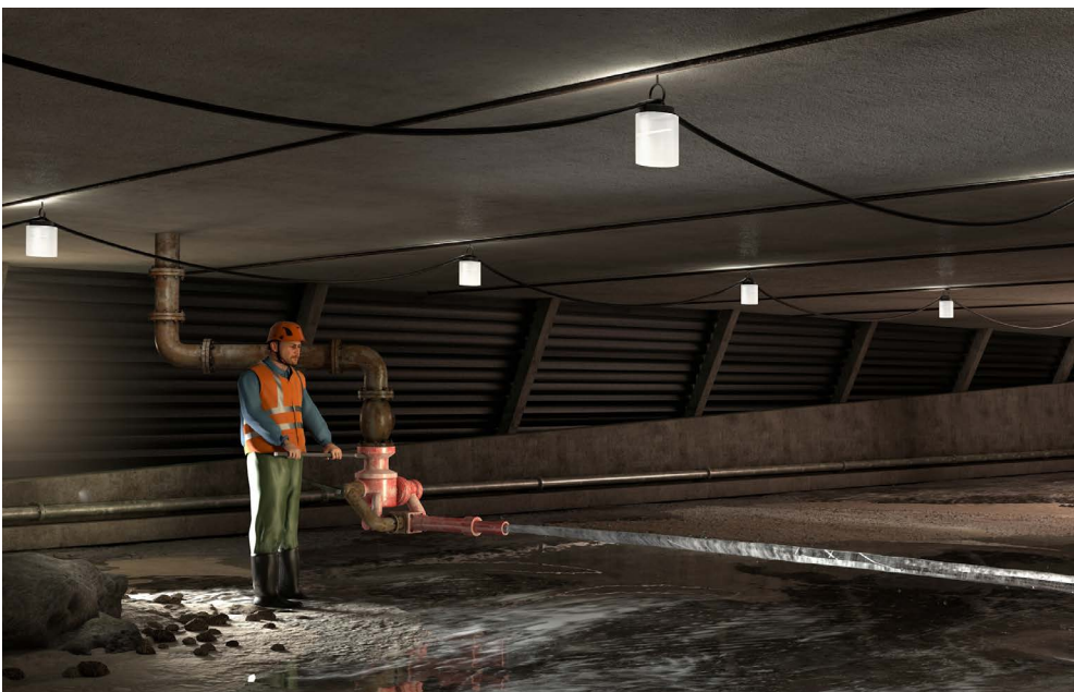
Abb. 16 Spülkanone mit fest verlegter Zuleitung
